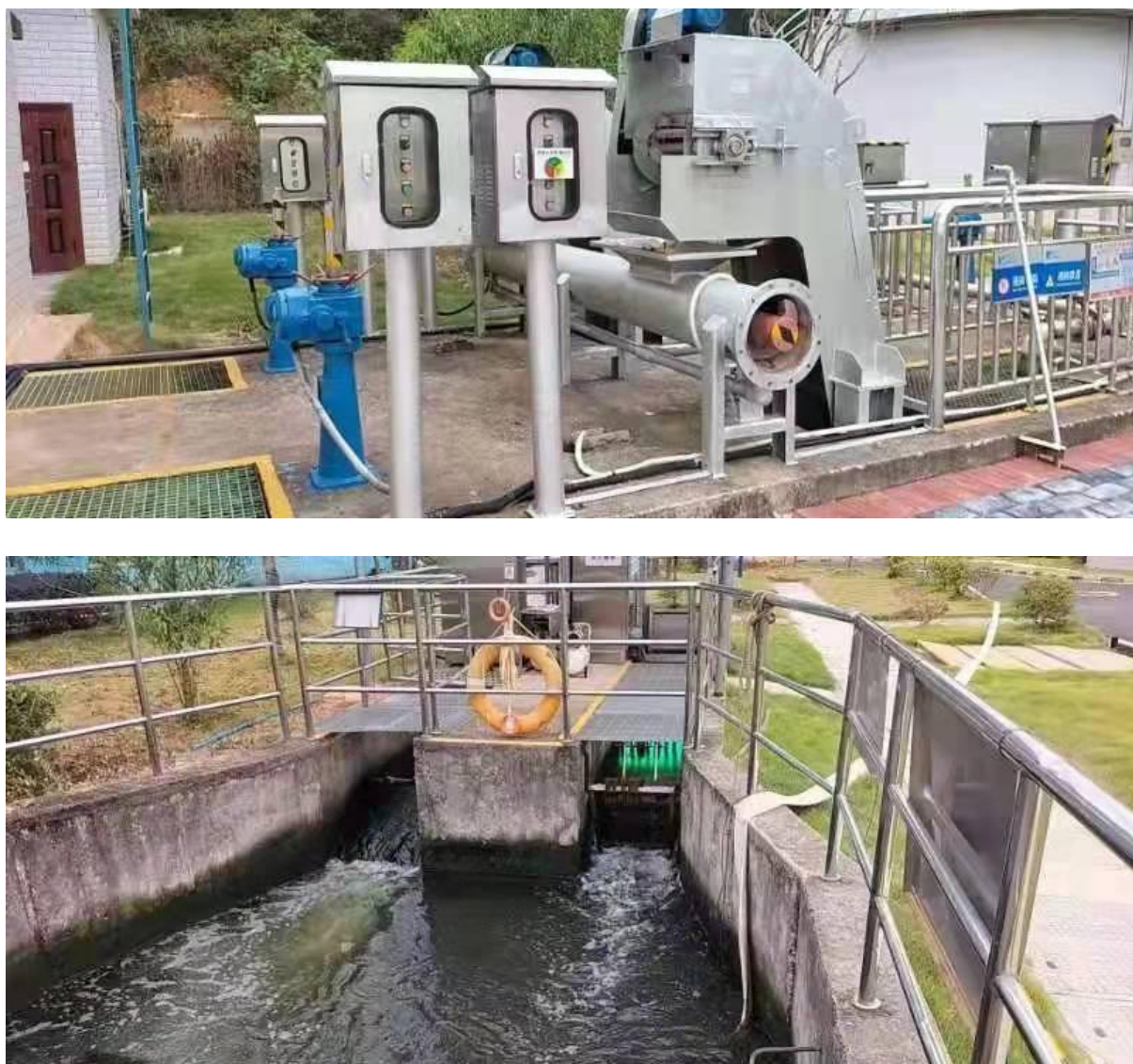
图 3.2-1 污水处理厂现状（格栅、CASS 池）
