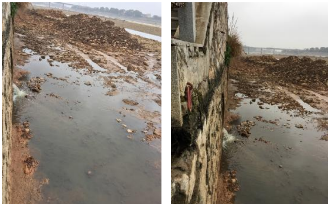
图 3.3-1 五一桥排口现状（污水正在溢流）
